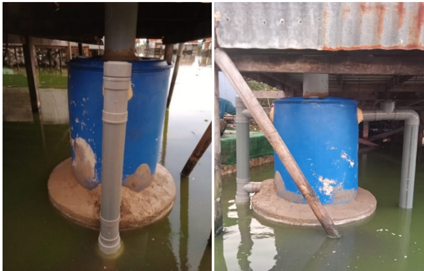
Gambar 3. Konstruksi teknologi tepat guna jamban yang telah dipasang di rumah warga
